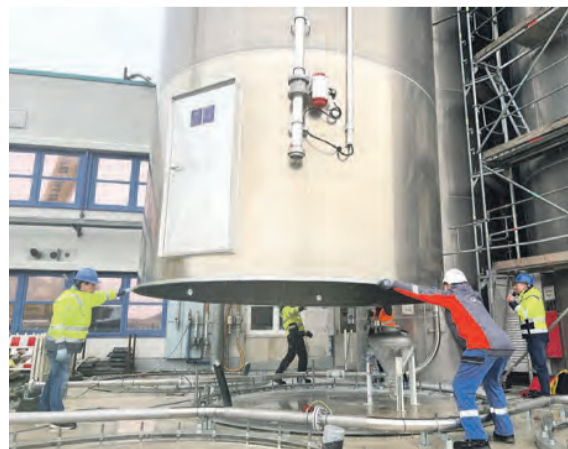
Rezyklat-Anteile in Profilen steigen stetig – im zusätzlichen Silo wird künftig Kunststoff-Granulat aus Altfenstern, gelagert. Foto: Marc Schenk, GEALAN
