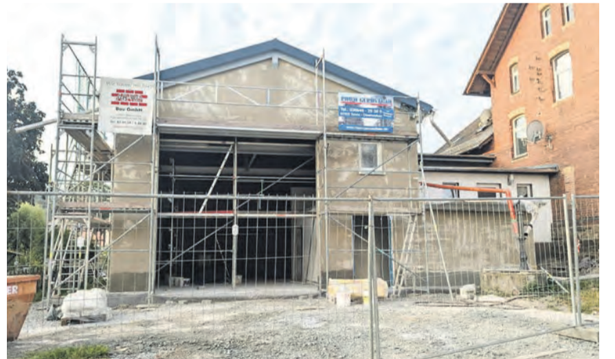
Am Bürgerhaus in Zollgrün konnte ein Anbau für verschiedene Nutzungsmöglichkeiten realisiert werden. Fotos: Michael Groth
