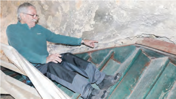
Peter Bergmann zeigt auf eine Stelle wo die Treppe bereits etwas abgesackt ist. Wie es mit dem markanten Turm weitergeht, weiß derzeit niemand.
