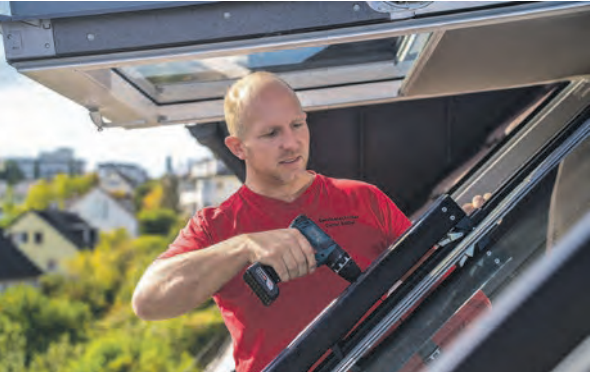
Besonders bei Dachfenstern, die konstruktiv noch in gutem Zustand sind, lassen sich viele typische Verschleißerscheinungen wirtschaftlich sinnvoll beheben. Foto: DJD/TLS-Dachfenster
